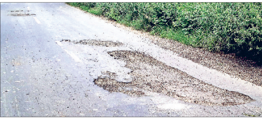
गन्नीौर। सड़क टूटने के कारण बने गड्ढे। फोटो: हरिभूमि
